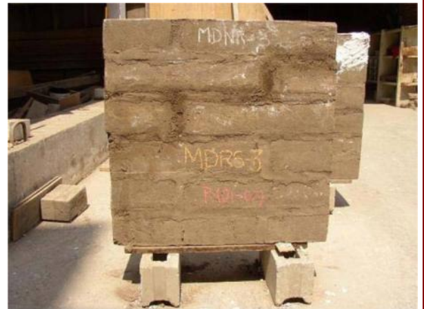
Figura 2. Reparación de muretes con grout de suelo: murete reparado. Laboratorio de Estructuras, PUCP. Investigadores Julio Vargas y Marcial Blondet.
