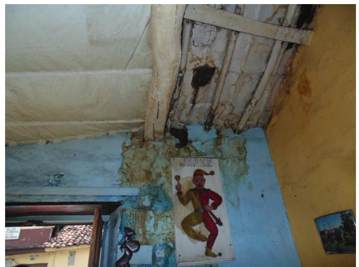
Figura 2. Edificación con presencia de daños en muros de adobe y de carrizo con recubrimiento de barro. Fuente: Gabriela Barsallo
