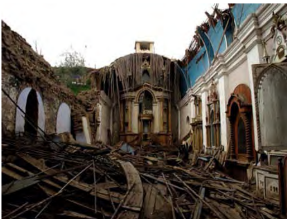
Iglesia de San Antonio de Mala, dañada durante el terremoto de Pisco del 2007 © J. Paul Getty Trust
