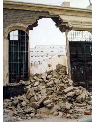
Fig. 10b – Falla por volteo.
