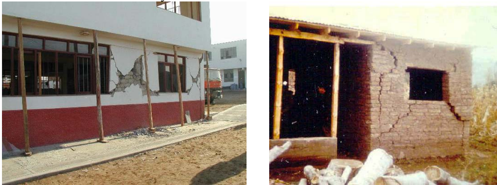
Fig. 11 – Grietas diagonales por corte en los muros.
