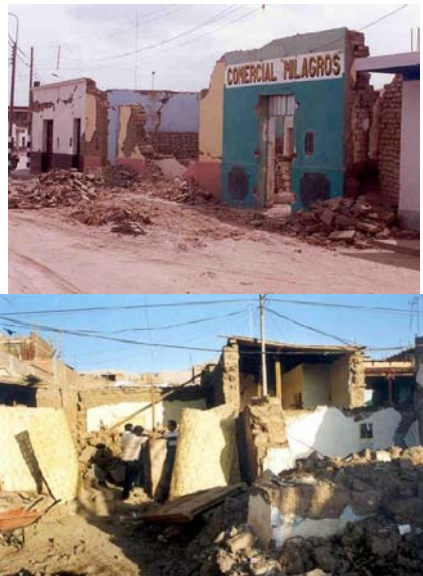
Fig. 3 – Daños en viviendas de adobe. Terremotos de Nazca (1996) y Arequipa (2001).
