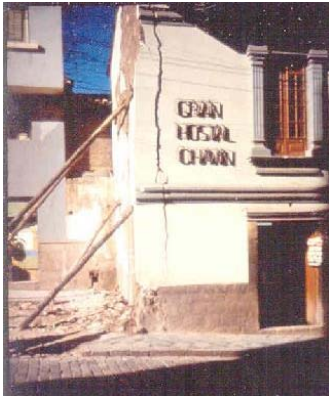
Fig. 10a – Agrietamiento de esquina.
