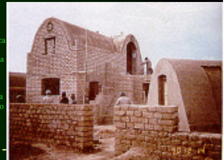
Proyecto "Laka Uta" (Casa de tierra) con técnica constructiva de cubierta en forma de bóveda parabólica autosustentada. Provincia Aroma del departamento de La Paz, Bolivia.
