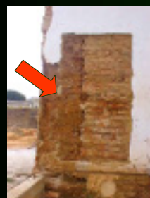
Parede remanescente de taipa de pilão, do tipo "formigão", que fechava a parte do corpo da guarda que dava para o pátio de armas.
