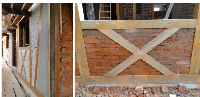
Figura 04: construção em estilo enxaimel, com tijolos assentados com argamassa de barro. Fonte: Juliana Moehlecke.
