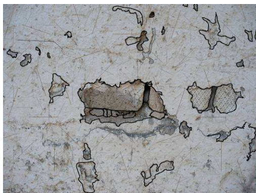
Fig.1 – Detalle de desprendimiento de revoque. (Paolo 2010)
