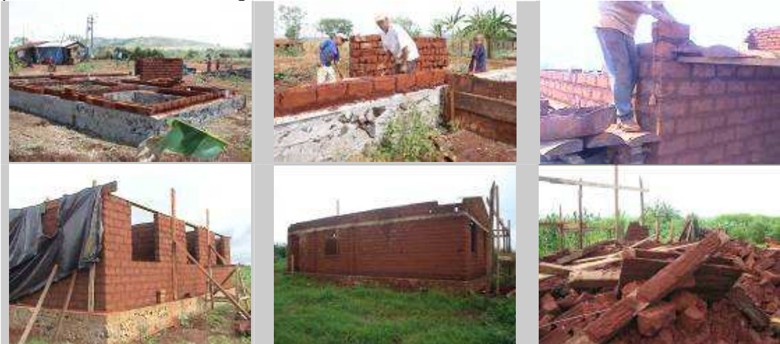
Figura 7 – Etapas de construção da casa com paredes autoportantes de adobe e do desmoronamento de uma delas (acervo HABIS).
