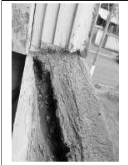
Foto 4. Condición de la base de la ventana
