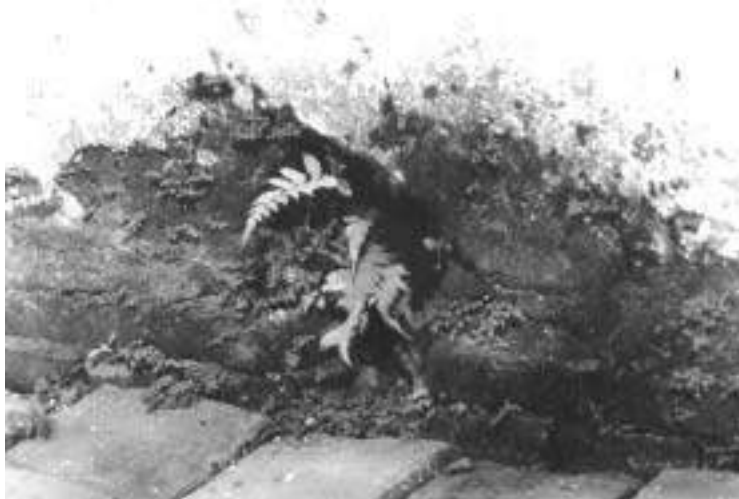
Foto N° 5 – Vegetación en los muros por efectos biológicos.
