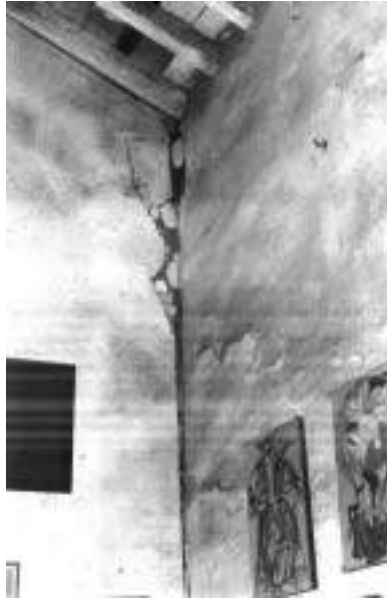
Foto N° 4 – Caída de revoques por efectos físicos y químicos.
