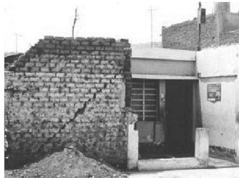
Fig. 2.5 Grietas diagonales en el muro
