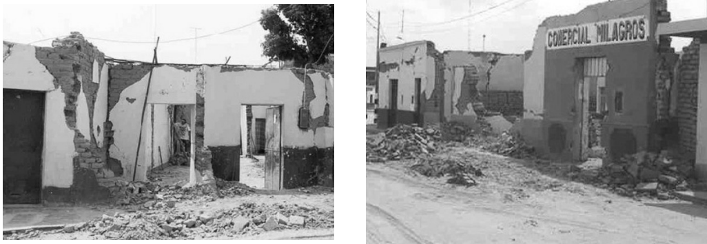
Fig. 2.2. Colapso sísmico de viviendas de adobe
