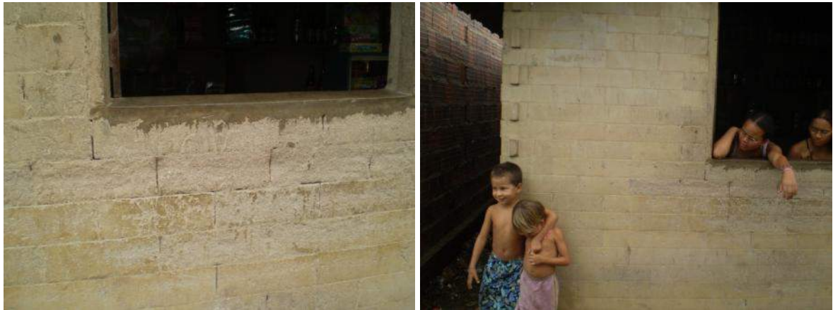
Figura 10 – Locais com desgaste abrasivo dos tijolos
