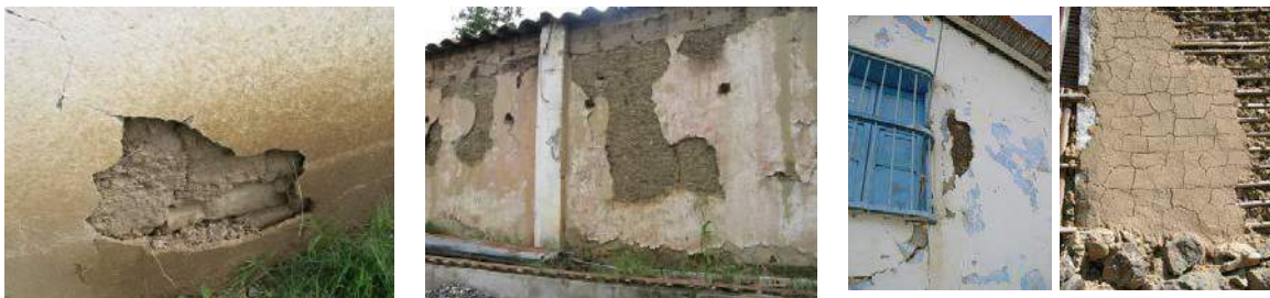
Figura 6 – Casos de lesiones graves, con desprendimiento generalizado del revestimiento, fisuras y disgregación del material
