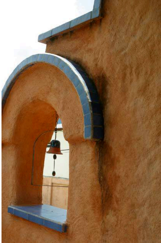
Figura 5 – Protuberancias o salientes en paredes expuestas, las grietas surgen por efecto de la erosión por agua
