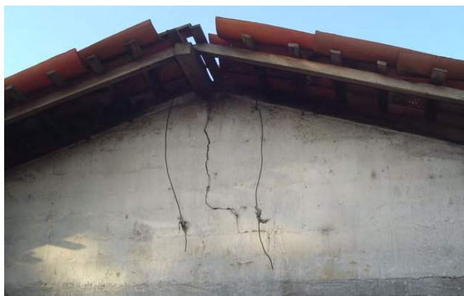
Figura 8 – Fissura causada pelo apoio direto da peça estrutural de madeira sobre o tijolo
