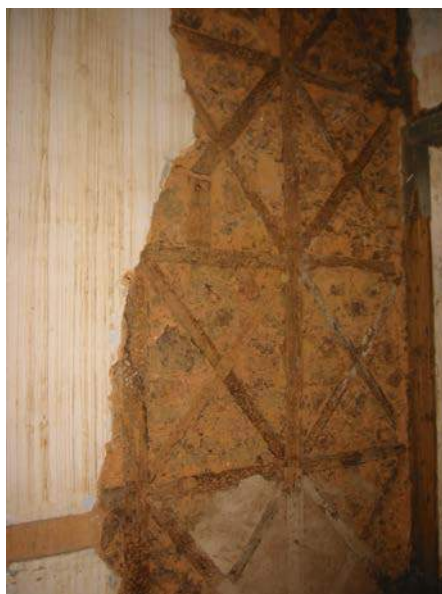
Figura 3 – Paredes do Solar dos Leite com reboco deteriorado, mostrando a estrutura em cruz de Santo André. Foto: Luisa Venancio
