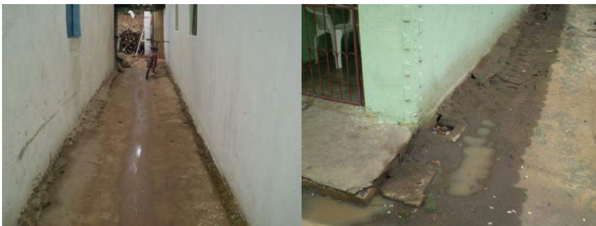
Figura 15 – Trecho com a base das paredes bem protegida por argamassa direcionando as águas (esquerda) e trecho permitindo infiltração de água na base da alvenaria
