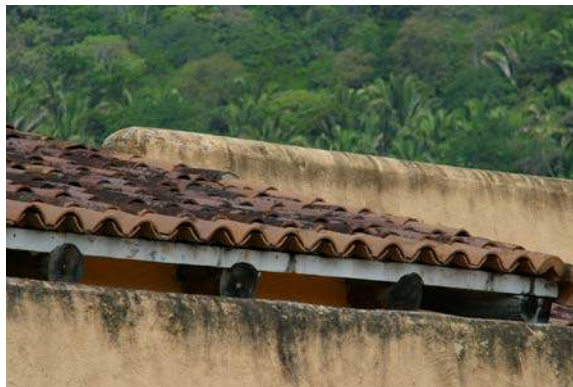
Figura 6 – Humedad y hongos por falta de capotes en los cantos de muros y escurrimiento de aguas lluvias
