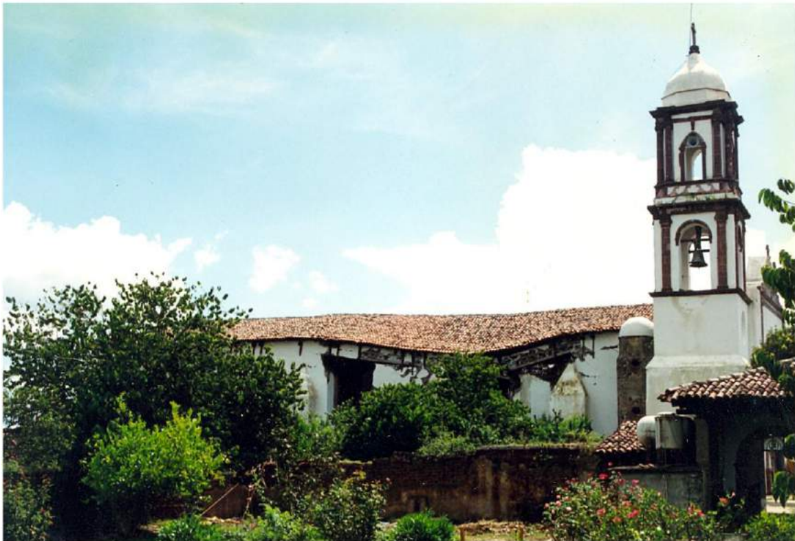
Figura 4 - Vista general de la nave; se aprecia el muro derrumbado y el colgamiento de la cubierta. Fotografía: Ulises Chávez
