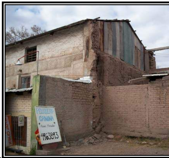
Figura 6 – Encuentro de muros norte y oeste
