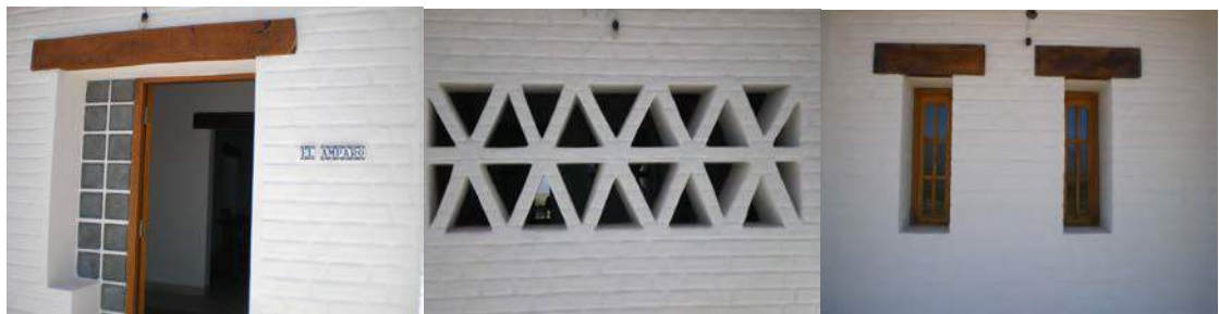
Figura 5 – Viga de madera en dinteles. Nido de abejas en lavadero
