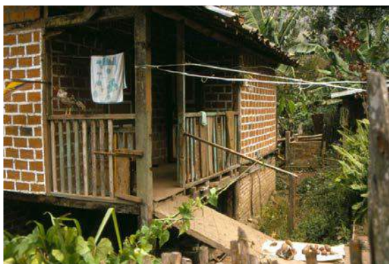
Figura 6 – Vivienda de ladrillo. Infestada
