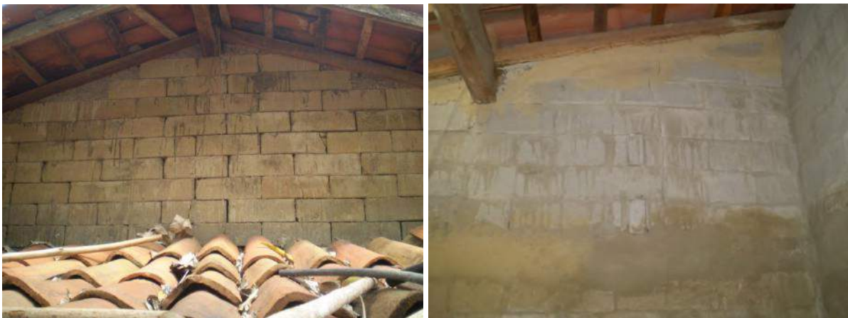
Figura 12 – Falta de limpeza da alvenaria quando da execução
