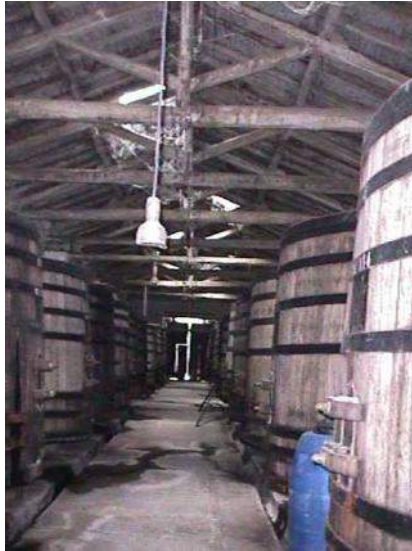
Figura 6 – Vista interior del segundo cuerpo de la bodega de adobe en 1998. Bodega Panquehua, Las Heras, Mendoza.
