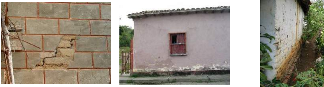
Figura 4 – Desprendimiento, eflorescencias y humedad localizada
