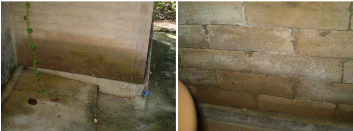
Figura 11 – Paredes com excessivo contato com água de respingos de chuva e com manchas de lixiviação na parte interna
