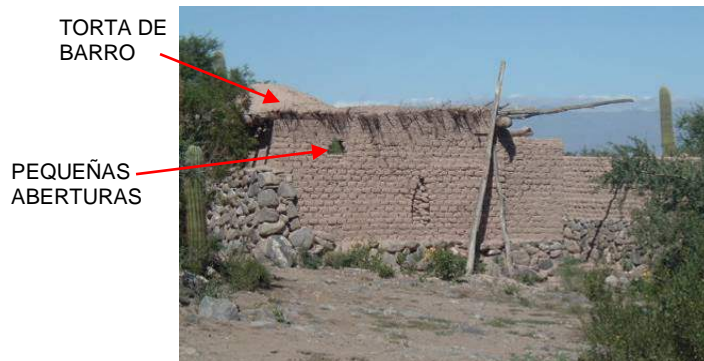
Figura 2 – Construcción tradicional de muros de adobes de gran espesor y pequeñas aberturas
