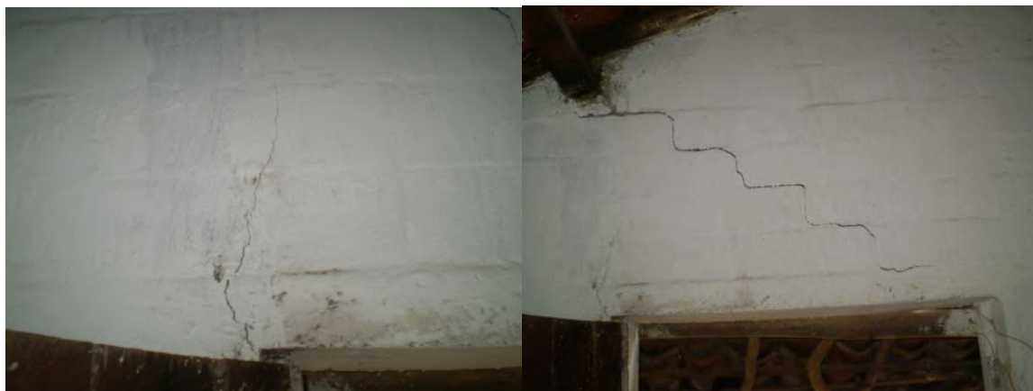
Figura 9 – Fissuras provocadas pela pouca rigidez da cinta sobre vãos de portas
