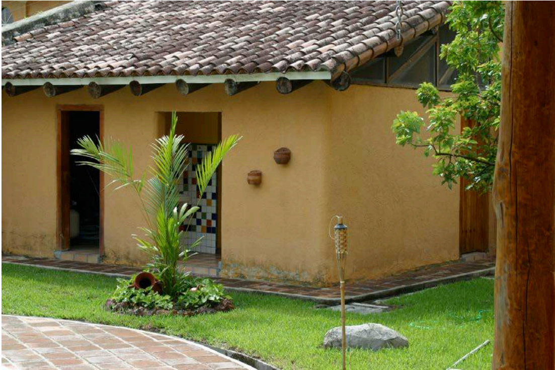
Figura 7 – Humedad ascendente por capilaridad y por rebote de aguas lluvias
