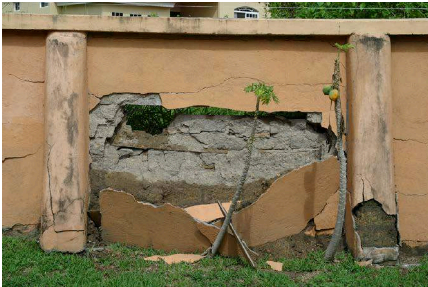
Figura 2 – Colapso por exceso de humedad, ya que se repelló solo una cara del muro, la visible hacia la casa
