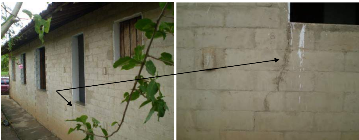
Figura 6 – Fissura em canto de janela encontrada no Centro Comunitário
