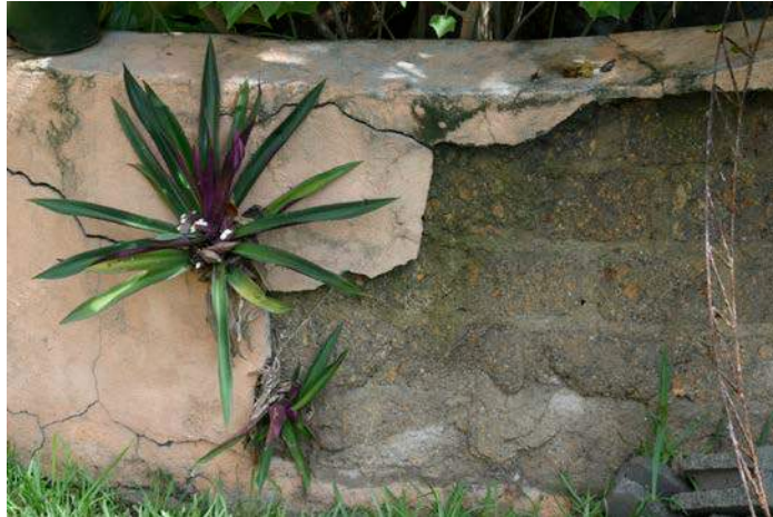
Figura 1 – El Trópico favorece la vida, inicia con el mocho, aparecen las grietas, nace la flora y llega el posterior colapso, primero del repello y luego del muro completo
