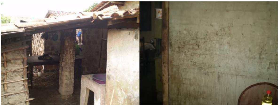
Figura 13 – Acréscimos feitos em algumas casas, prejudicando o aspecto estético e a habitabilidade, e parede suja por falta de higiene
