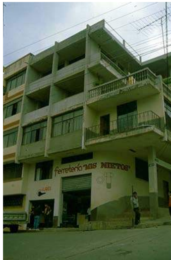
Figura 11 – Vivienda urbana de materiales modernos, infestada. Tenía madera de construcción “guardada” en la terraza. Foto: 1995, Piñas, Patricio Cevallos S.
