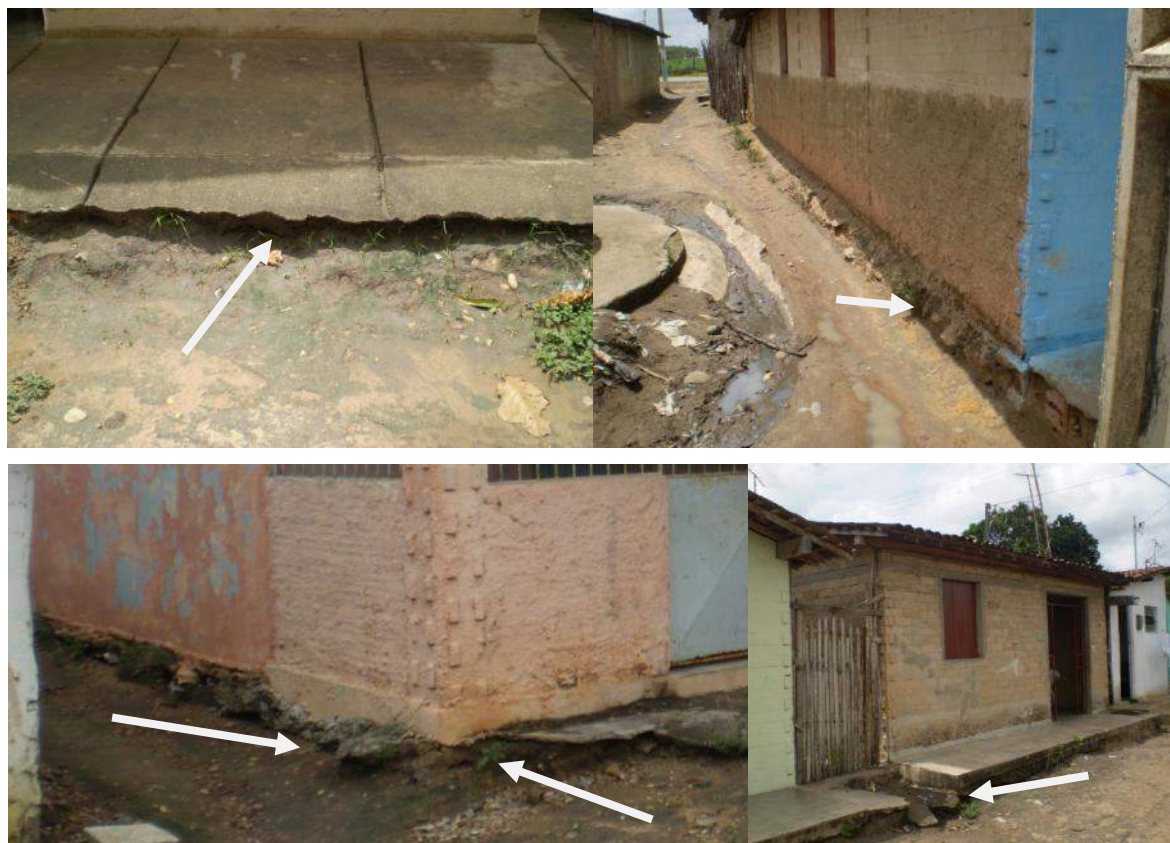
Figura 14 – Calçadas e fundações sendo descalçadas pela erosão do solo e falta de cuidado dos moradores
