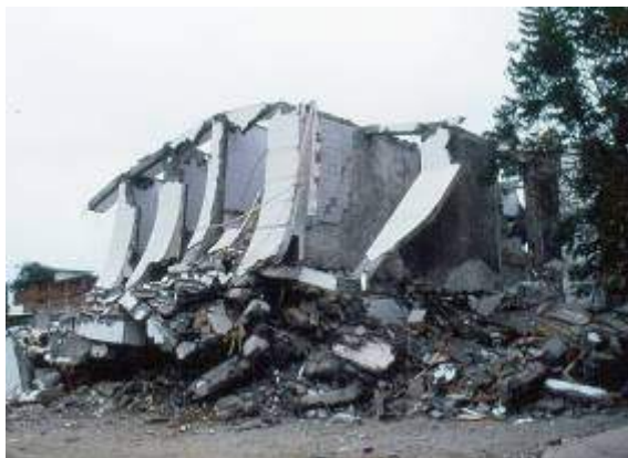
Fotografía 11 Estructura de hormigón armado colapsada por mal diseño y posibles errores constructivos. Cubierta liviana mal diseñada, con
