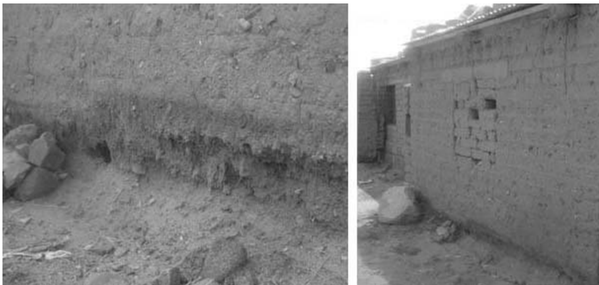
Figs 3 y 4. Presencia de patologías constructivas relacionadas con la humedad por la ausencia de sobrecimientos en la edificación. En este caso urbano se verifica la presencia de humedad y desgaste de los adobes próximos al nivel de suelo. Casa urbana, Susques, 2009.
