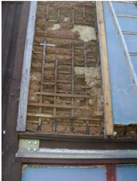
Foto 3 – Painel exposto após queda do barreado.
