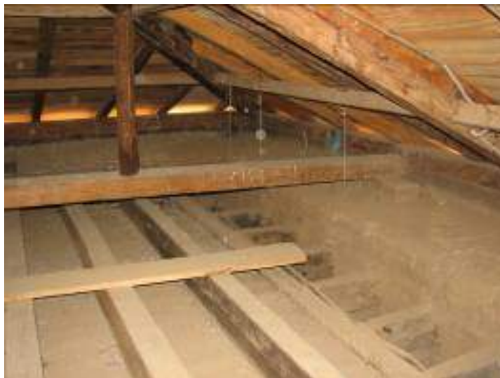
Fig. 5 Vista de estructura mostrando disposición de vigas pares (Fotografía de F. Méndez).
