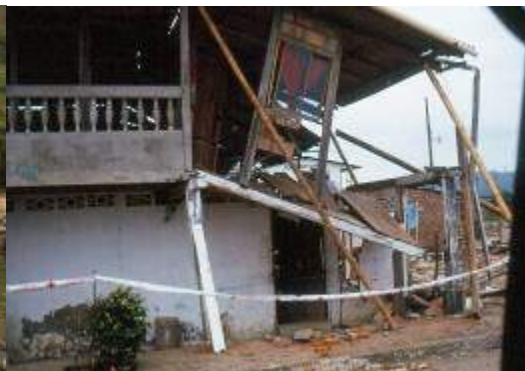
Fotografía 14 La falta de mantenimiento de la madera, especialmente de la expuesta a la intemperie causa su pudrición, se fractura y ocasiona colapsos en parte o toda la estructura
