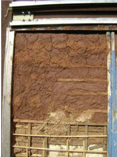
Foto 5 – Rachaduras apresentadas durante secagem do barreado.
