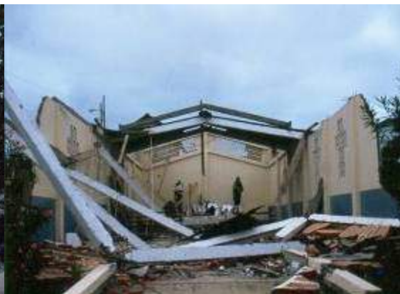
Fotografía 12 colapso en el encuentro de hormigón armado, falló la unión y el anclaje a las vigas-solera de la cubierta
