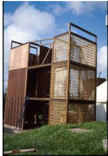
Foto 4 – Painéis inteiros expostos.
