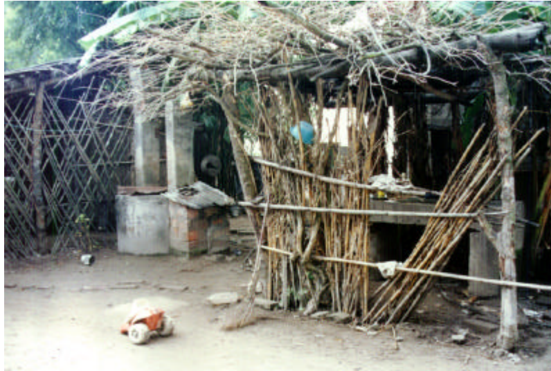
Foto 3: Patología de las construcciones con caña.
