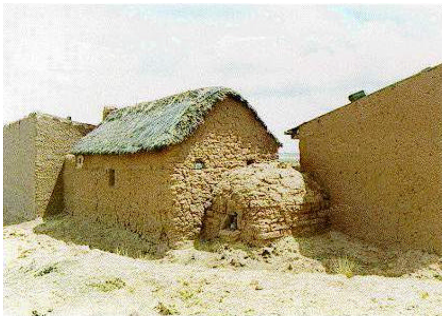
Foto 2: Precariedad constructiva en una vivienda rural en el Altiplano de Bolivia (Foto: A. Calla)
