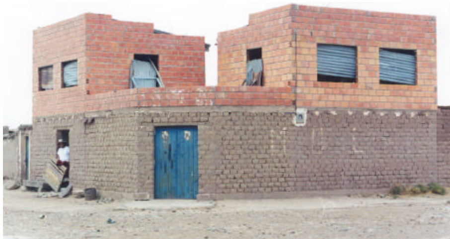
Foto 3: Viviendas de la periferia urbana con planta baja edificada con adobes, planta alta de ladrillo y cubierta de calamina. (Foto: A.Calla)
