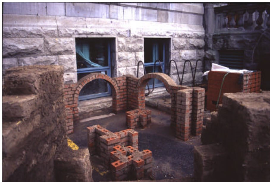
Foto 6: Construcción de muros en adobe y diversos arcos en el curso ministrado en la Universidad McGill, el primero en el ámbito académico dentro de todo el territorio Canadiense ( Jean D'Aragon, 2002 ).
