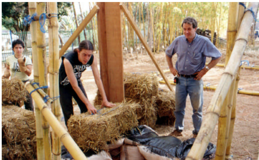
Foto 4 : Construcción de un módulo aplicando la técnica constructiva de la paja ( Márcio Buson 2000 ).
