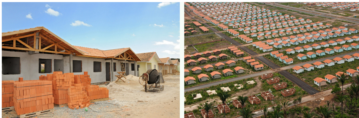
Figura 1. Construções em bloco cerâmico, no Paraná (01/12) e no Piauí (12/11). Fonte: Divulgação do Programa [brasileiro] de Aceleração do Crescimento (PAC) pelo Governo Federal.
