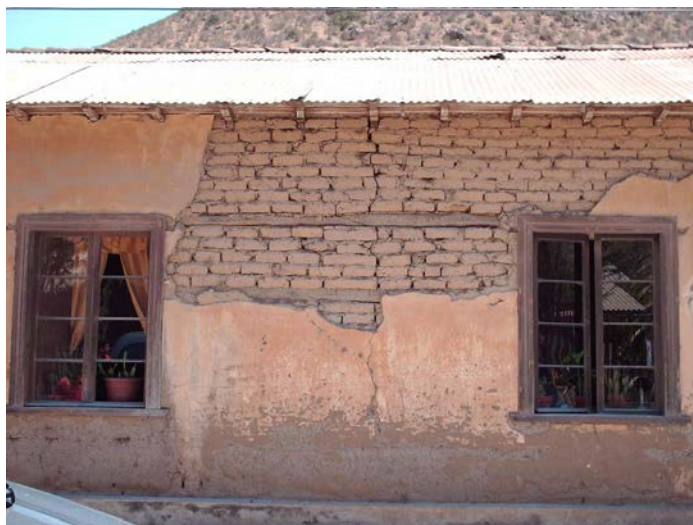
Figura 3. Presencia de las llaves de madera evidenciadas cuando caen los estucos. (Créditos: Natalia Jorquera)
