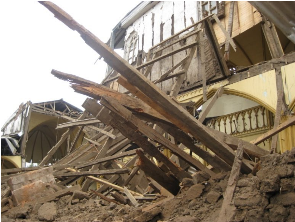
Figura 1. Fotografía de la Iglesia de Chanco post terremoto de febrero de 2010
