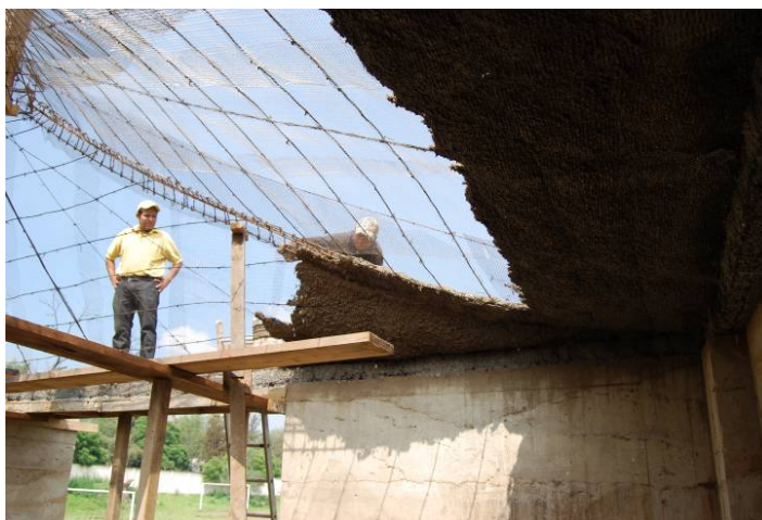
Figura 5. La primera capa de hormigón de tierra sobre la malla metálica del techo (Foto: L. Guerrero)
