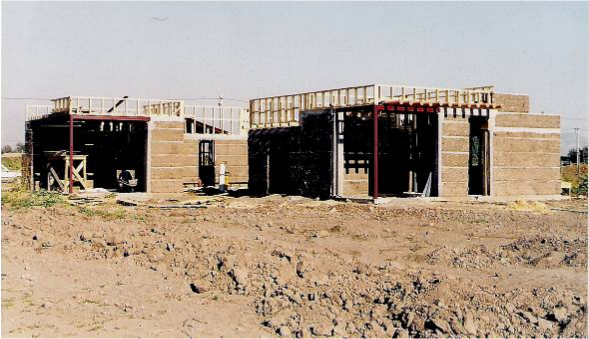
Figura 4. Casa Sr. León Codriansky en etapa de construcción, Comuna de Colina, Chile Foto H.Pereira. (Geo referencia: Lat -33°,24' Long -70°,71')
