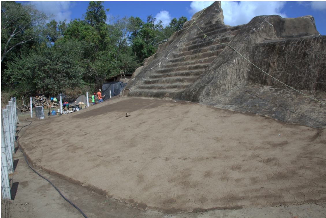
Figura 3. Muro de contención Oeste en la fachada de la pirámide para distribuir el agua y evitar afectación a la estructura (Foto A. Daneels, 24 de enero de 2013).
