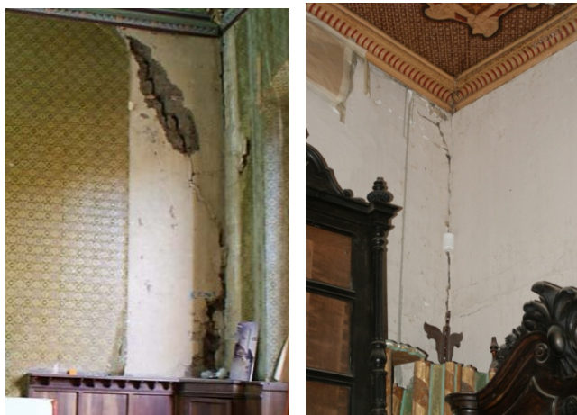
Figuras 4 y 5. Encuentro de muro de adobe con pared de ladrillo, y muro de bahareque con pared de adobe
