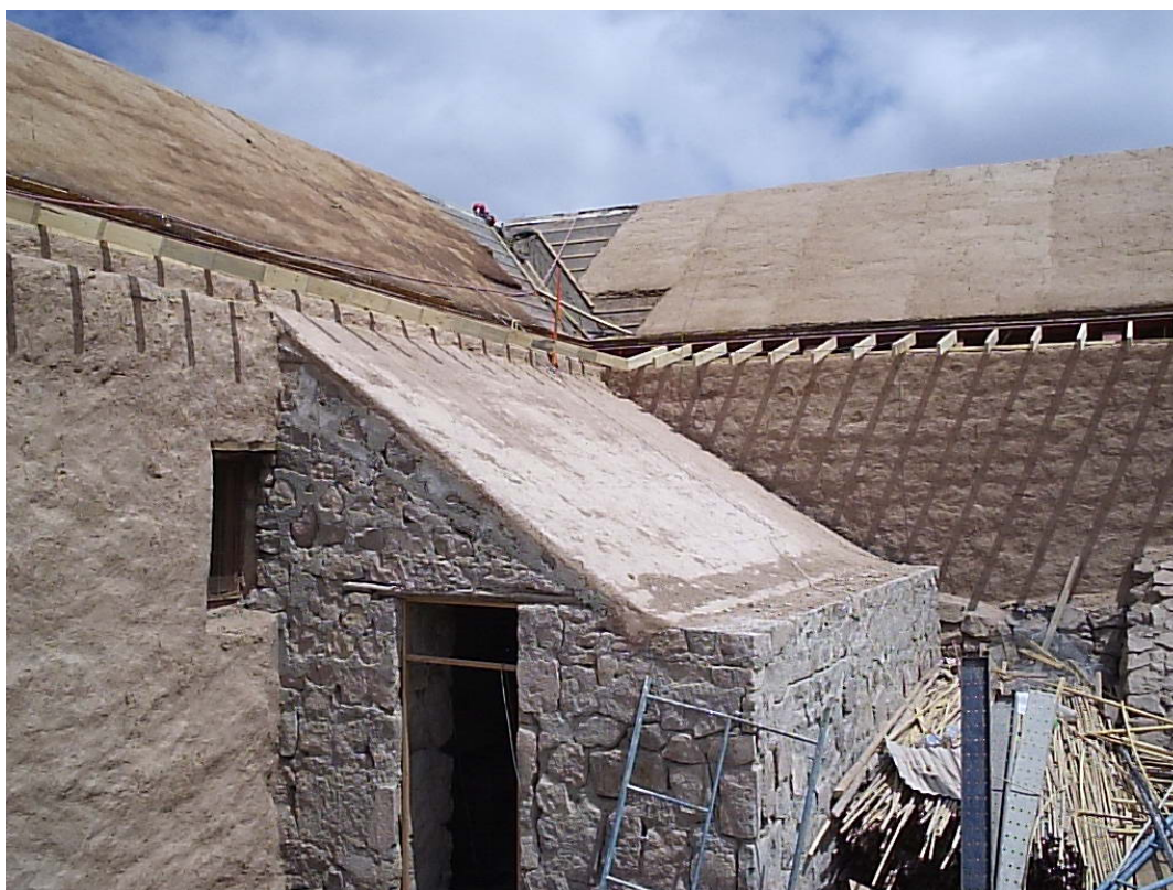
Figura 4. Reconstrucción de cubierta con barro y paja. Canes falsos de madera. Vista del nor-oriente
