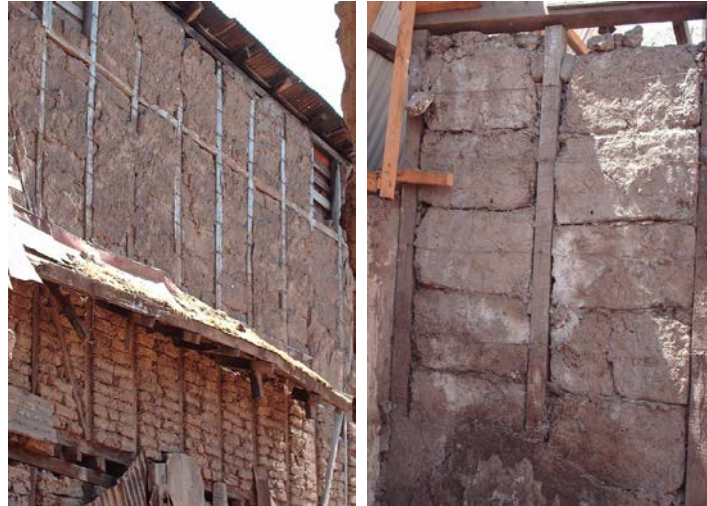
Figura 4. Detalle del sistema mixto madera-tierra cuya debilidad son las conexiones. (Créditos: Natalia Jorquera)
