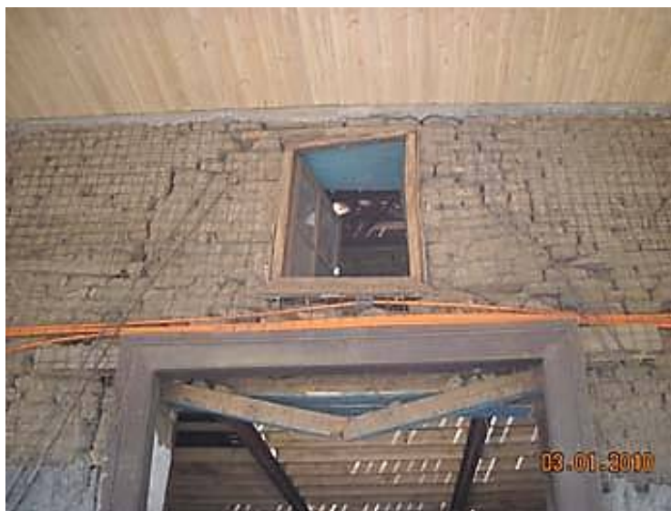
Figura 1. Iglesia San Pedro de Alcántara, post-terremoto, marzo 2010
