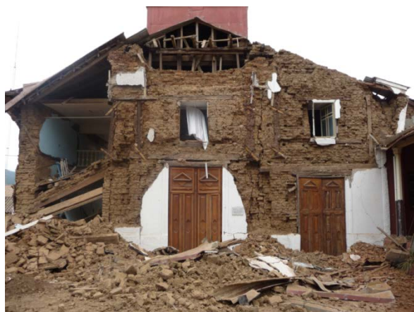
Figura 2. Iglesia de Curepto, Región del Libertador Bernardo O'Higgins. Estado del edificio luego del terremoto del 27 de febrero de 2010.
