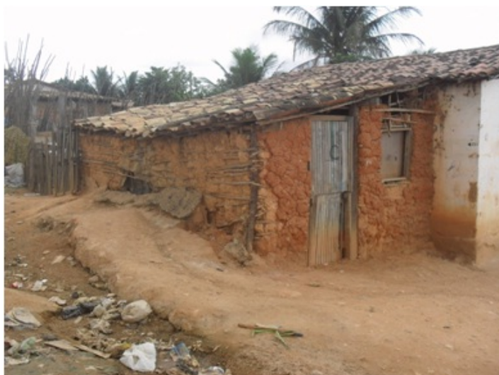
Figura 2 - Falta de preocupação com a fundação
