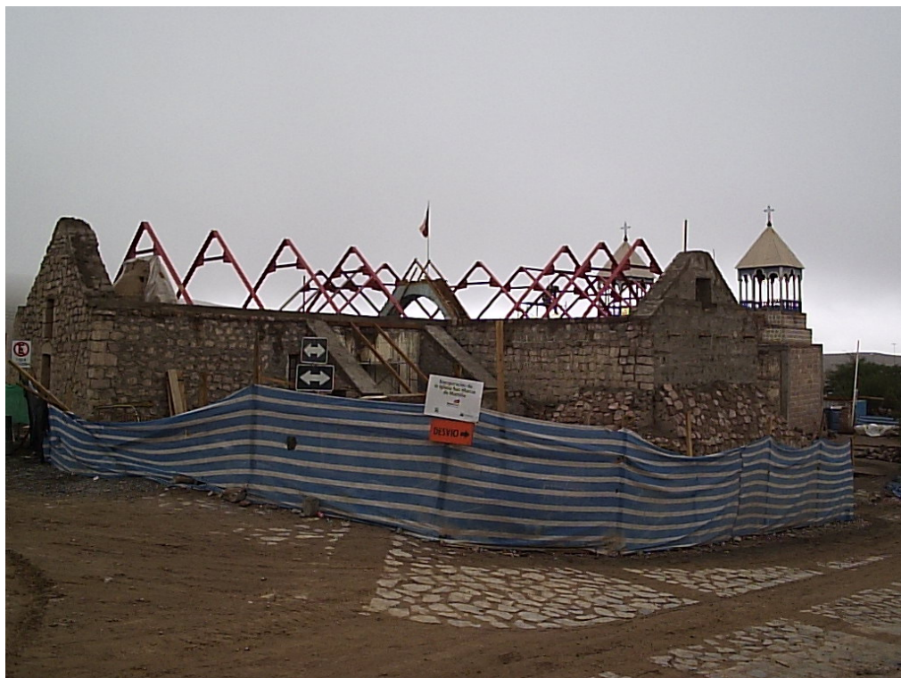
Figura 5. Vista obra desde el Nor-orient. Se aprecian estructuras metálicas de cubierta introducidas
