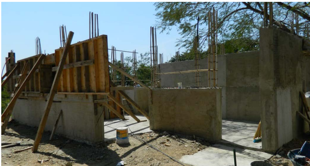
Figura 5: Fachada principal, proceso de cimbrado. En primer plano los castillos de reglillas de bambú. Foto: Aranda, Marzo 2013.
