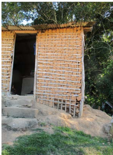
Figura 4. Casa sem fundação apoiada sobre uma pedra, madeiras de baixa qualidade, paredes expostas com a parte inferior danificada e beiral pequeno
