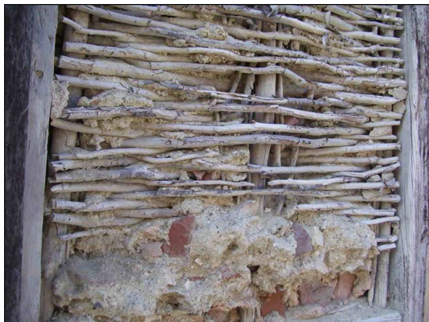
Figura 5. Lesiones en el tipo constructivo 1
