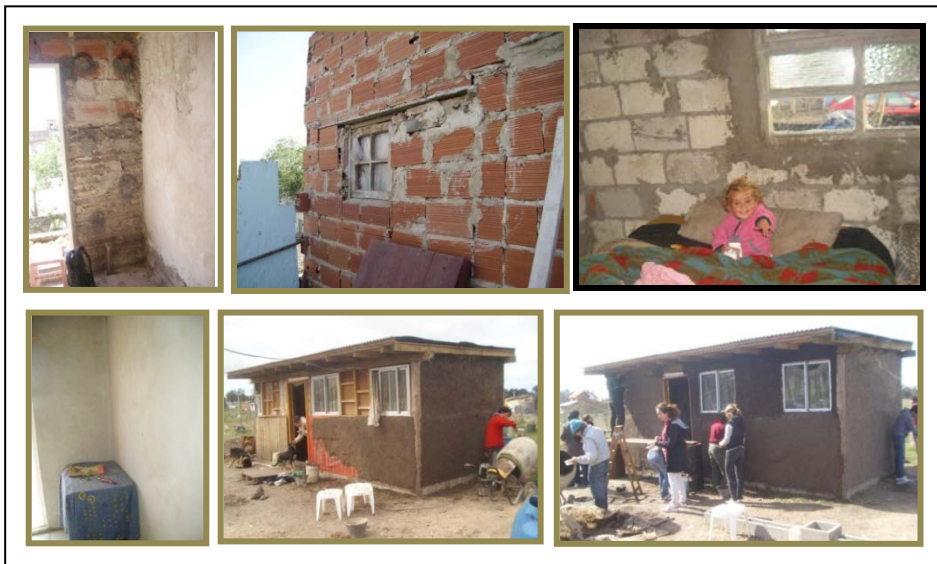
Figura 3: Situaciones de muros sin revocos en viviendas autoconstruidas (arriba). Prototipos de revocos de suelo-cemento-cal y de barro sobre malla metálica en Bancalari, Monte Terrabusi y Nuevo Golf (abajo) (Créditos: Rotondaro, 2008, Cacopardo, 2011).
