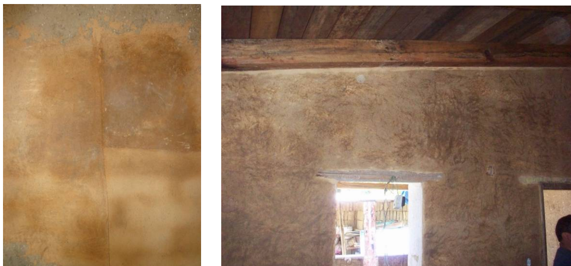
Figuras 7 y 8. Bruñidos en recubrimientos de muros. Foto: autor, 2012.
