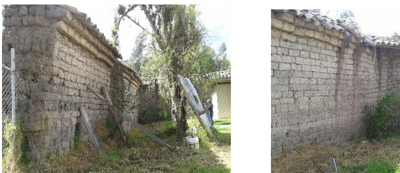
Figura 1 – Muro 1: Cerramiento del Hospital Mariano Estrella, mayo 2015
