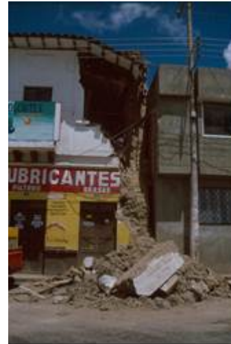
Figura 3 – Vivienda de hormigón construida junto a la de tierra golpeó y fracturó el muro de adobe
