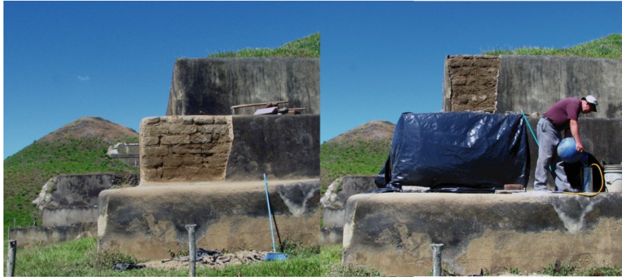
Figura 5– Partes deñadas en la esquina Sureste de la Estructura 2.
