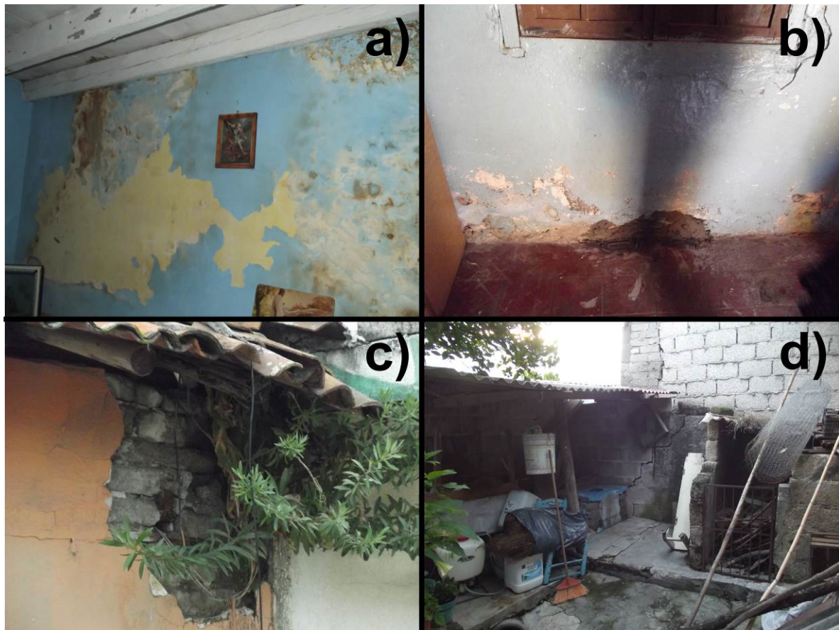
Figura 6. Tipos de problemas en las viviendas de adobe de Malinaltenango. a) Humedad y escurrimiento en muro; b) Agujeros de ratón tapados con cemento; c) Planta que creció en casa abandonada; y d) Cuarteadura en muro de bloques de hormigón, provocada por la cercanía a la barranca oeste.
