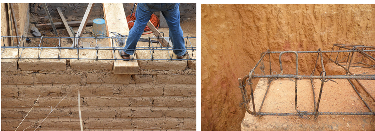
Figura 7. Armado con grapas de acero amarradas a cada 60 cm para anclar la estructura de madera a los muros
