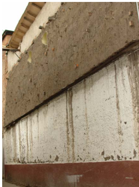
Figura 3. Estado de la cara exterior del muro al momento de la intervención. Crédito: Baquero, 2014
