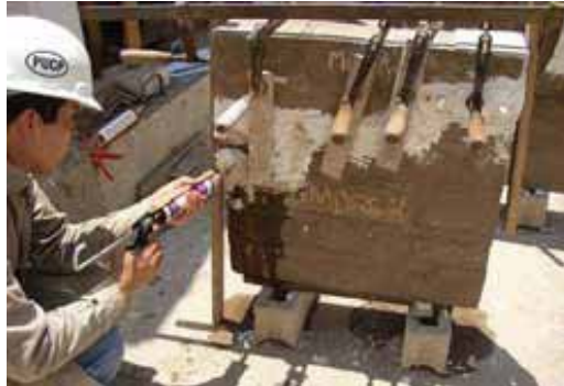
Figura 3. Inyección de barro líquido en grietas (Blondet et al, 2007)
