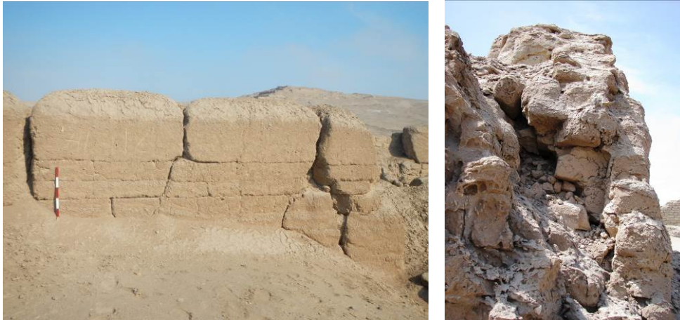
Figura 3 – Agrietamiento de muros. Fuente: Manual de conservación Pachacamac
