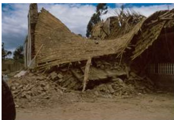
Figura 5 – Ausencia de refuerzo en los muros
