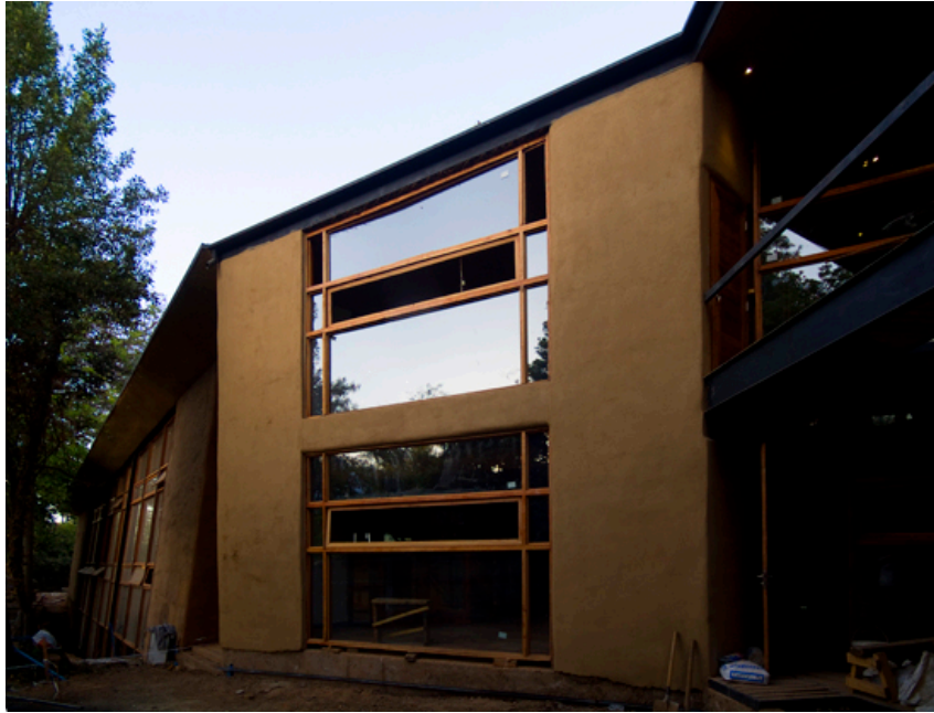
Figura 13- Centro de Ecología Aplicada. Obra del arquitecto Marcelo Cortés en Santiago de Chile. Crédito: Andrés Cruz
