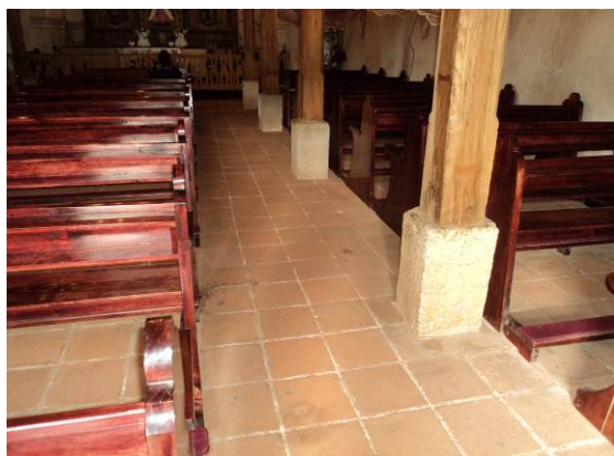
Figura 9. Estado actual del piso interno de baldosa de barro cocido. (Quiñónez, 2015)
