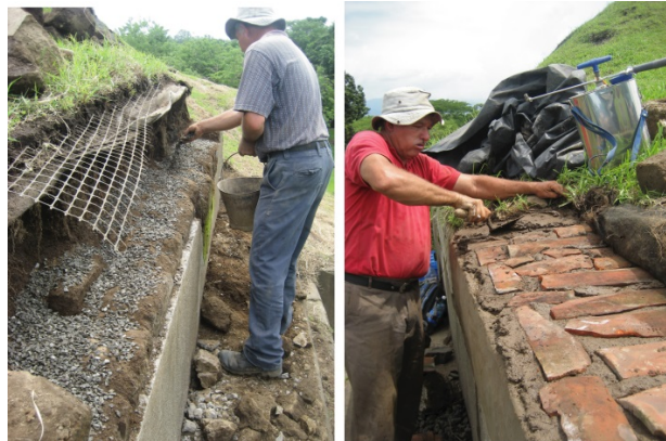
Figura 3 – Uso de pedrín suelto para hacer notar la intervención y uso de teja para cuidar los adobes de la humedad.
