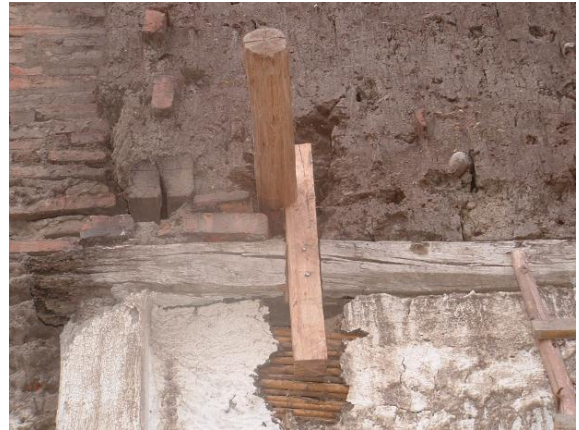
Figura 5. Vigas llaves en la cara exterior del muro de adobe. Crédito: Baquero, 2014
