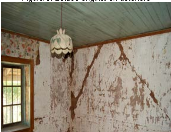
Figura 7. Grietas en muro dormitorio
