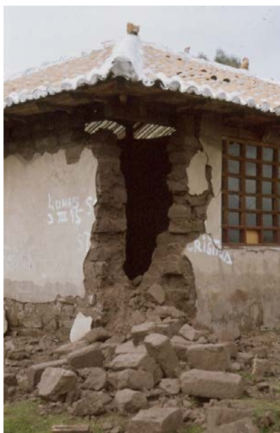
Figura 7 – Esquinas con defectos por trabajos de albañilería
