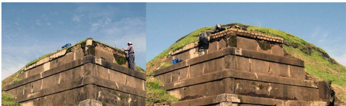
Figura 2 – Esquina Noreste dañada y colocación de adobes para formar la cornisa.
