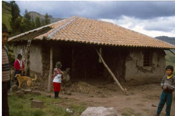
Figura 9 – La falta de vinculación de la solera con el muro libre de adobe, permitió que este se “desprendiera” de la cubierta y colapsara
