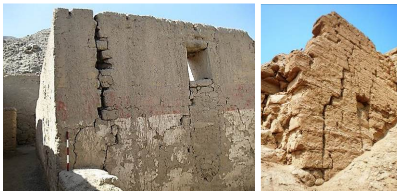
Figura 1. Vista de muros arqueológicos de tierra con agrietamientos que afectan su estabilidad
