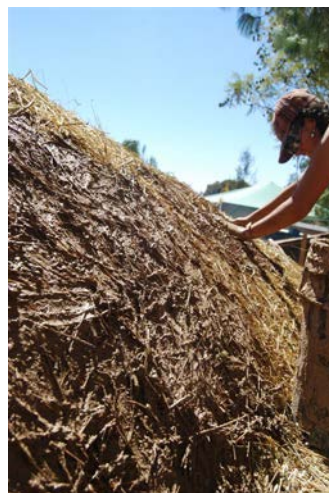
Figura 4. Capas sucesivas y alternadas de paja colocada sobre revoques frescos de tierra arcillosa. (Foto: L. Guerrero, 2013).
