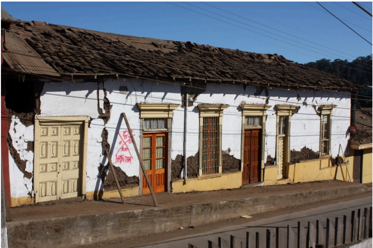
Figura 2- Zona central de Chanco marzo del 2010, a un par de semanas del terremoto 8.8 con epicentro a pocos kilómetros 1 . Crédito: Cristian Muñoz
