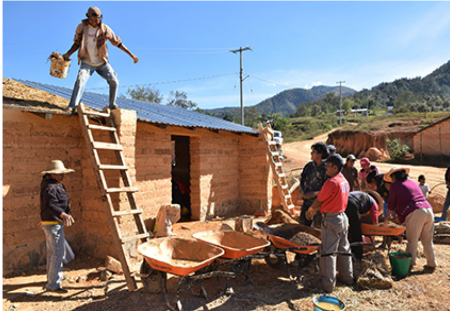
Figura 11. Taller práctico de autoproducción en adobe reforzado para construir la casa del pueblo, comunidad El Obispo, Malinaltepec, Gro.
