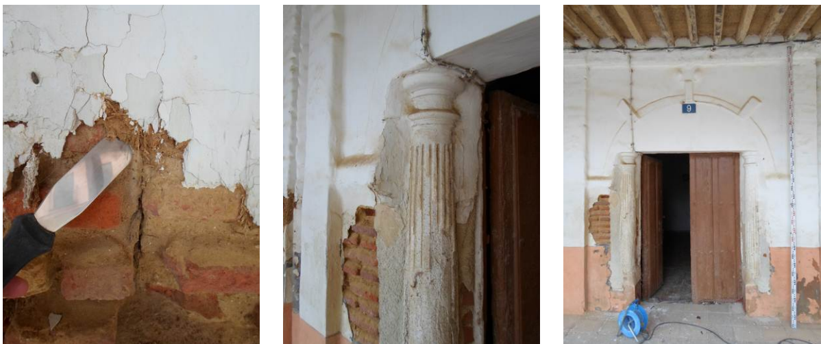
Figura 2. Casa-Hospital de la Vera Cruz de San Juan, Villalón de Campos, España. Aspectos figurativos de la fachada y toma de muestras (GrupoTIERRA, 2015)
