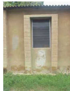
Fig. N° 4 Descontinuidad de los contrafores
