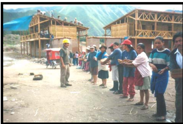
Fig. : Las faenas comunales contribuyeron al proceso de construcción del Centro de Salud de Qotowincho. Mujeres transportando tejas desde el camino hasta el techo de la edificación.
