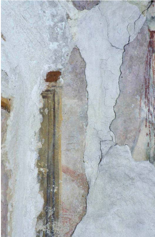
Fig. 4 – As argamassas colocadas há anos acusam fissuras verticais
