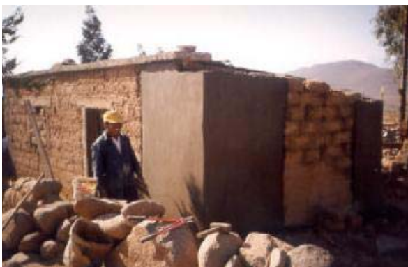
Fig. 10 - Colocação de uma camada de argamassa de cimento e areia, na zona reforçada com malha electrossoldada. In Técnicas para el Reforzamiento Sísmico de Viviendas de Adobe
