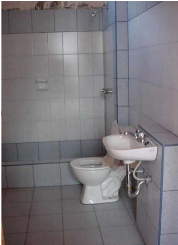
Fig : Paneles sanitarios fabricados de quincha y revestidos de cerámica para no dañar el muro de adobe
