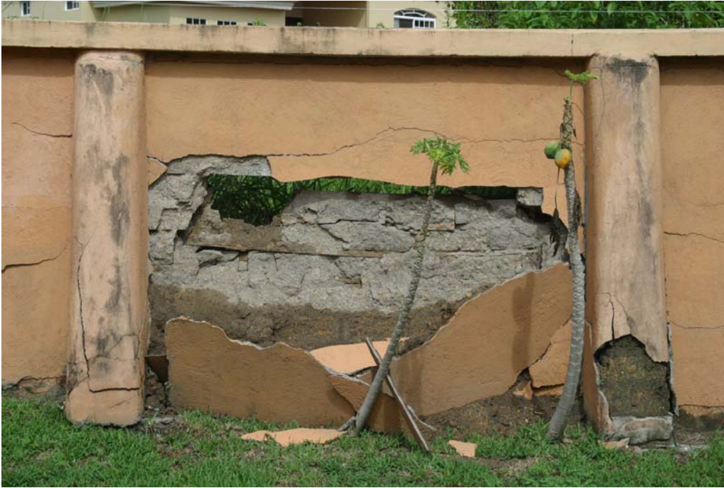
Fotografía 2. Colapso por exceso de humedad.
