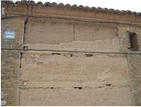
Fig.4 – Detalle de la fachada. Se aprecia el estado de conservación de los tapias y su enlace con los machones de ladrillo. Las fisuras del alero son producidas por el empuje horizontal de los pares de cubierta. (Fotografía de los autores)
