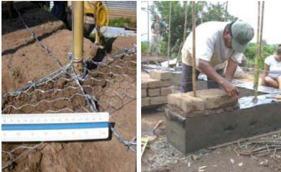
Fig. 6 - Colocação do reforço vertical com canas de bambu, e reforço horizontal com rede de galinheiro, El Salvador. In Construcciones de Adobe Resistentes a los Terremotos
