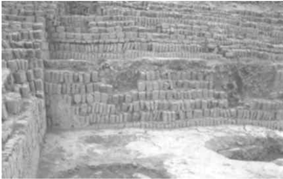
FIGURA 1 Estado original de la banqueta a intervenir. Obsérveselos deterioro por desplome de los componentes
