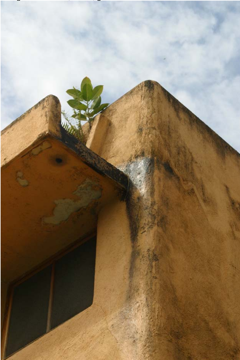
Fotografía 1. Flora, Moho, grietas.
