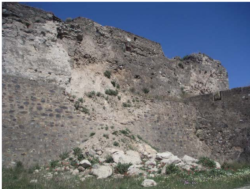
Fig. 4 – Troço Nascente da muralha islâmica, visto do exterior: zona recentemente derruída.
