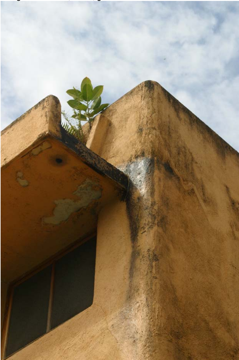
Fotografía 1. Flora, Moho, grietas.
