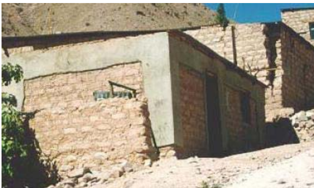
Fig. 14 - Habitação com reforço de malha electrossoldada sem danos (primeiro plano). Atrás encontra-se uma casa sem reforço, estando severamente afectada depois do sismo de Arequipa, Peru em 2001. In Comportamiento ante el terremoto del 23-06-2001 de las viviendas de adobe reforzadas en Moquegua, Tacna y Arica
