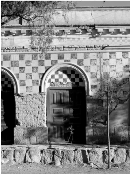
Fig. 2 (desprendimientos nivel inferior de muro y micro fisuras en coronamiento)
