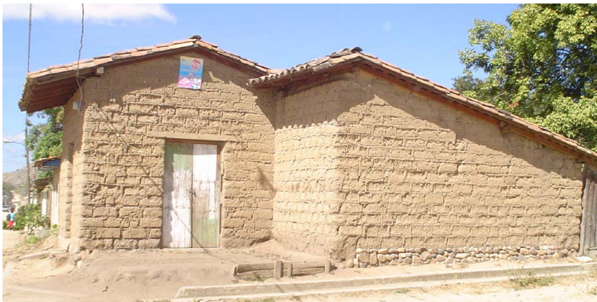
Fig. 1 Vivienda en la ciudad de Ocotol que es ejemplo del adobe degradado, en el que se evidencia el abandono de la simetría, de los aleros amplios, de los acabados y del cemento aislante. Fotografía de la autora
