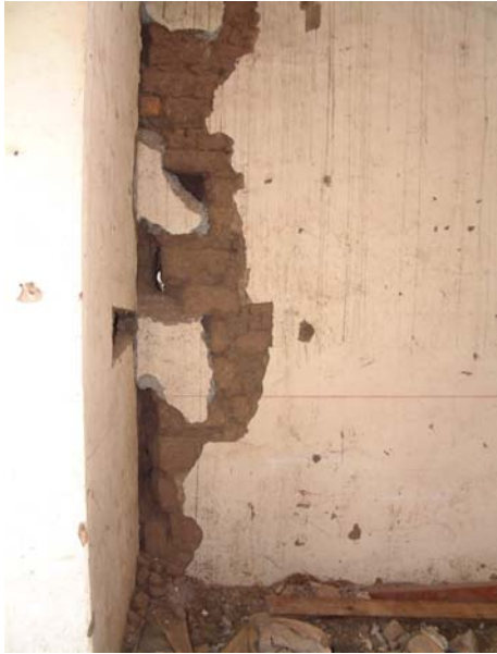
Fotografía 1. La imagen muestra la junta ente dos muros perpendiculares entre sí, nótese como estos no están unidos, al punto que se puede observar al otro lado de ellos por una espacio de mas de 5 centímetros, además se puede observar como en una intervención mal realizada se han hecho trabas de hormigón de pésima calidad y es evidente como estos no han cumplido el objetivo.
