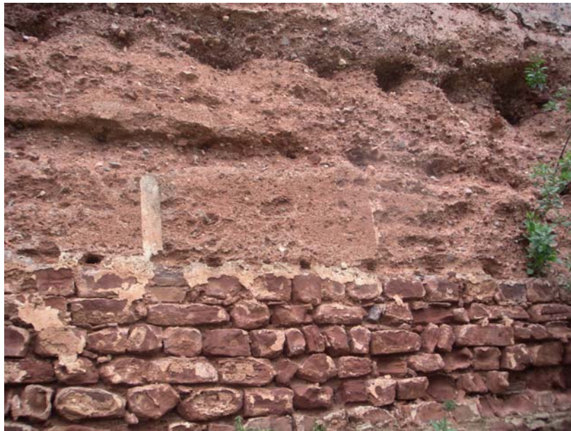
Fig. 4 – Troço Norte da muralha da medina de Silves, pelo exterior: são visíveis vestígios de pinturas nas juntas dos taipais.
