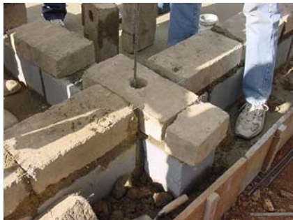
Fig. N° 3 Armado no adecuado de las juntas de bloques en contrafuertes
