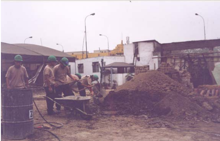
Figura 2. Construcción de Modulo de Adobe (Area de Taller) – Sede de la ETL – Cuartel de Santa Catalina - Lima
