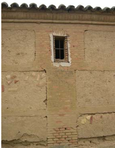
Fig.3 - Detalle de un machón de ladrillo en el que podemos apreciar cómo se modifica su anchura en la parte alta para poder albergar el hueco de la ventana. (Fotografía de los autores)
