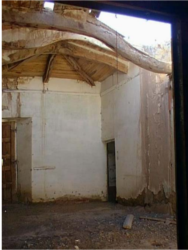
Fig. 5.- Detalle del estado de deterioro Casa Wayar, Pueblo de Cachi – Valles Calchaqués, Salta, Argentina. (Foto Archivo del DePAUS)
