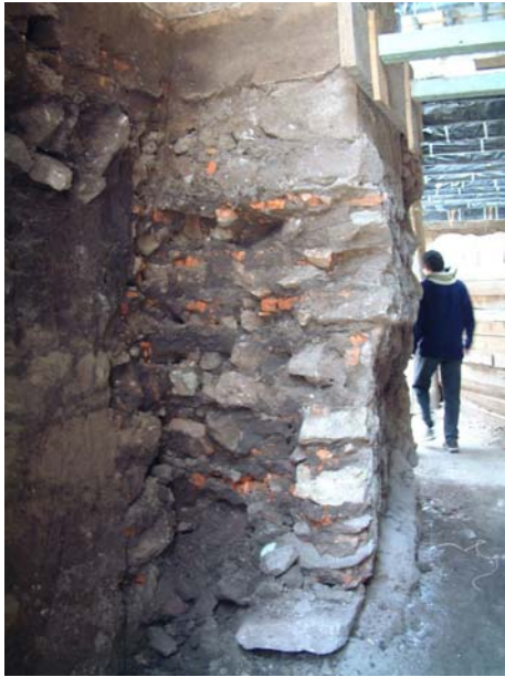
Fotografía 2. Caso típico de cimentación de muro, no existe material homogéneo que permita una correcta transmisión de cargas.
