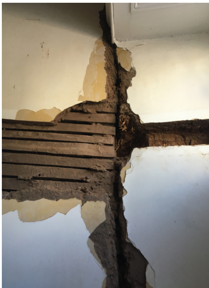
Fig 2. Encuentro muro interior de quincha y muro de adobe. Autora: Natalia Jorquera
