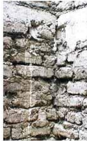
Fig.14: Trabe esquinero mal elaborado
