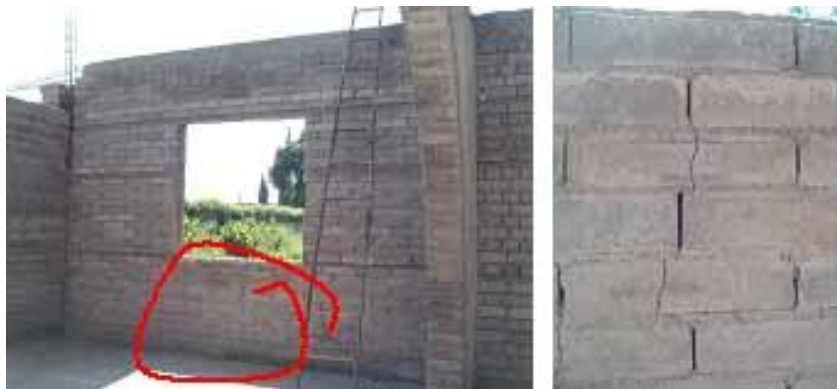
Figura 4-A Contracción por secado en juntas verticales entre tapias, Se lleno la separación entre juntas con mezcla (cal y arena). Revestimiento cerámico interior con buña de 2,5 cm para disimular el trabajo de la junta de dilatación.
