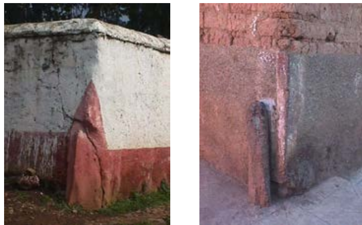
Fig. 10: Amarres sismorresistentes en piedra sobre las esquinas de muros de adobe. (Armani, 2002)
