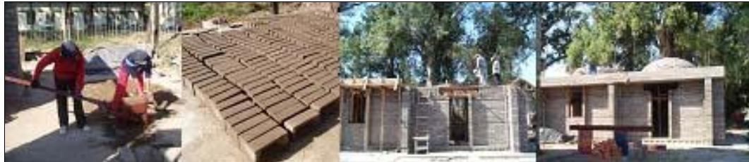
Fig.1 Producción del componente | Componente BTC | Construcción del elemento muro | Muro módulo 4 Oficina
