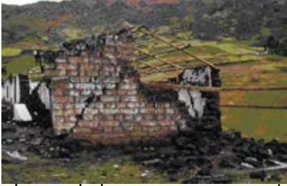
La cubierta mal diseñada, las soleras sin anclaje a los muros, los muros de mala calidad y con mucha altura.
