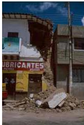
Fig. 12: Vivienda implantada muy cerca del talud. Su caída en el muro correspondiente al talud fue debido al deslizamiento del suelo. La vivienda de hormigón construida adosada al muro de adobe golpeó y fracturó el muro de adobe.
