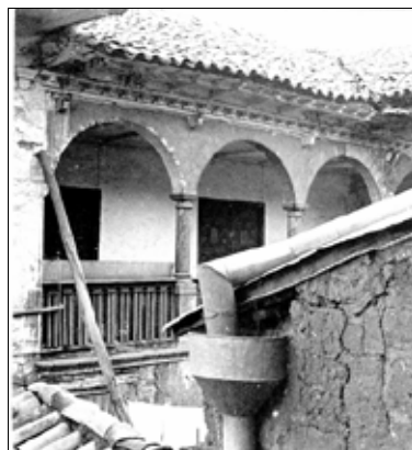
Fig. 2. Falta de mantenimiento
