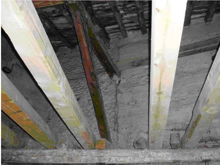
Fig. 2.- Muro mixto de machones de ladrillo y cajones de tapial en el lado del Evangelio de la Iglesia de Jesús Nazareno, visto desde el bajo cubierta de la Casa de Hermandad anexionada.
