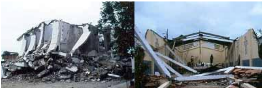
Fig.9: Estructura colapsada por mal diseño y errores los tijerales constructivos. Cubierta liviana de asbesto cemento mal diseñada.
