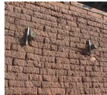
Fig. 9: Llaves de madera empleadas como refuerzo a nivel del entresuelo de madera. (Armani, 2002)
