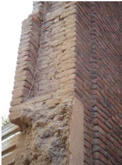
Imagen 4. Cajeadado de la obra de ladrillo para ejecutar la tapia de tierra trabada con la de ladrillo, que se puede ver en la demolición parcial de la tapia del convento de las Salesas.
