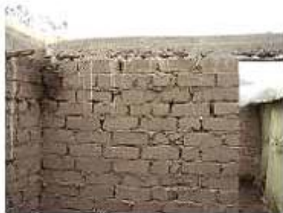
Esquinas con defectos por trabajos de albañilería.
