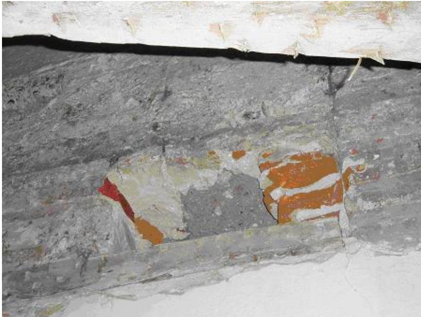
Fig. 3.- Detalle de la verdugada del muro ejecutada mediante un solo ladrillo de espesor y dos hiladas de grueso, al fondo se observa la tierra apisonada del cajón de tapial. Se observa también la ausencia de traba entre el "macho" y la verdugada.
