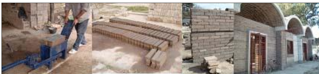
Fig.2 Producción del componente | Componente BaTC | Construcción del elemento muro | Muro módulo 3 Aula-Taller
