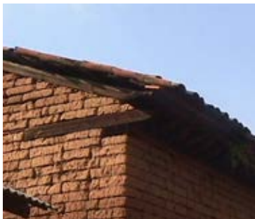
Fig. 7: Viga de cerramiento colocada a modo de refuerzo de la estructura del muro a fin de evitar su deslizamiento en la base del altillo.
