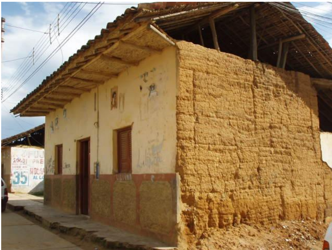
Foto 1. Vivienda parcialmente demolida como consecuencia del sismo.
