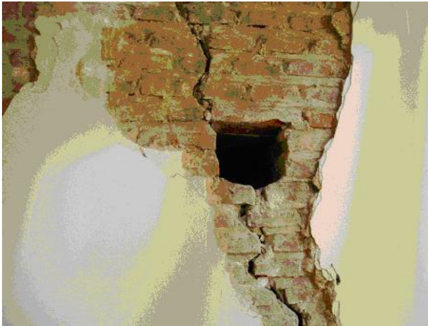
Fig. 4.- Detalle del “ agujal ” dejado en la construcción del machón de ladrillo. Una fisura vertical recorre la fábrica como consecuencia de un asiento ya estabilizado.
