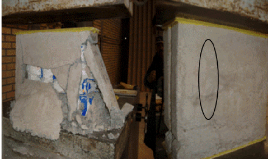
Figura 4. Falla desarrollada en los módulos del sistema propuesto expuestos a carga a compresión. Lado derecho falla longitudinal, lado izquierdo, falla transversal
