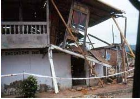
Fig.11: La falta de mantenimiento de la madera, especialmente de la expuesta a la intemperie causa su pudrición, se fractura y ocasiona colapsos en parte o toda la estructura.
