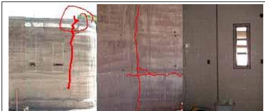
Figura 4-B: Fisura int.-ext. bajo ventana en B D y G
