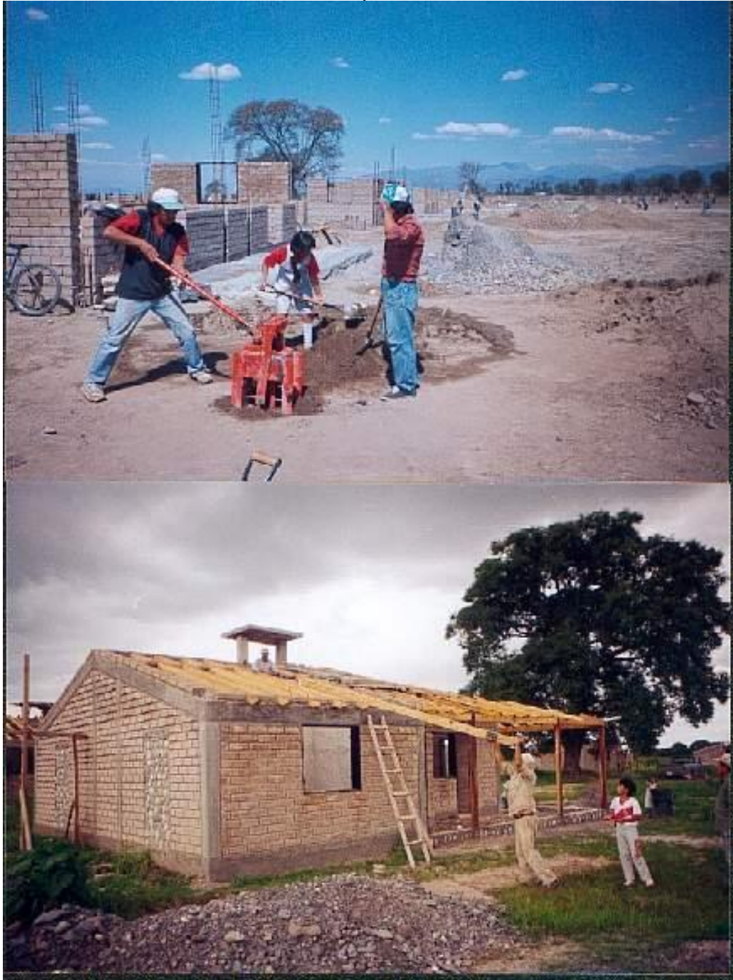
Fig. 1: Fabricación de bloques de suelo cemento y armado de estructura de madera para cubierta (B° Ecosol – 1998)
