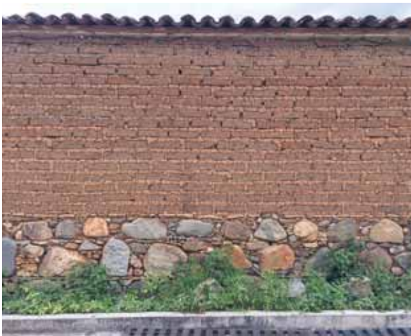
A pesar de la acumulación de agua provocada por los pavimentos de cemento, los zócalos de piedra asentada con lodo evitan la ascensión capilar y protegen las bases de los muros de adobe. Huayapam, Oaxaca.
