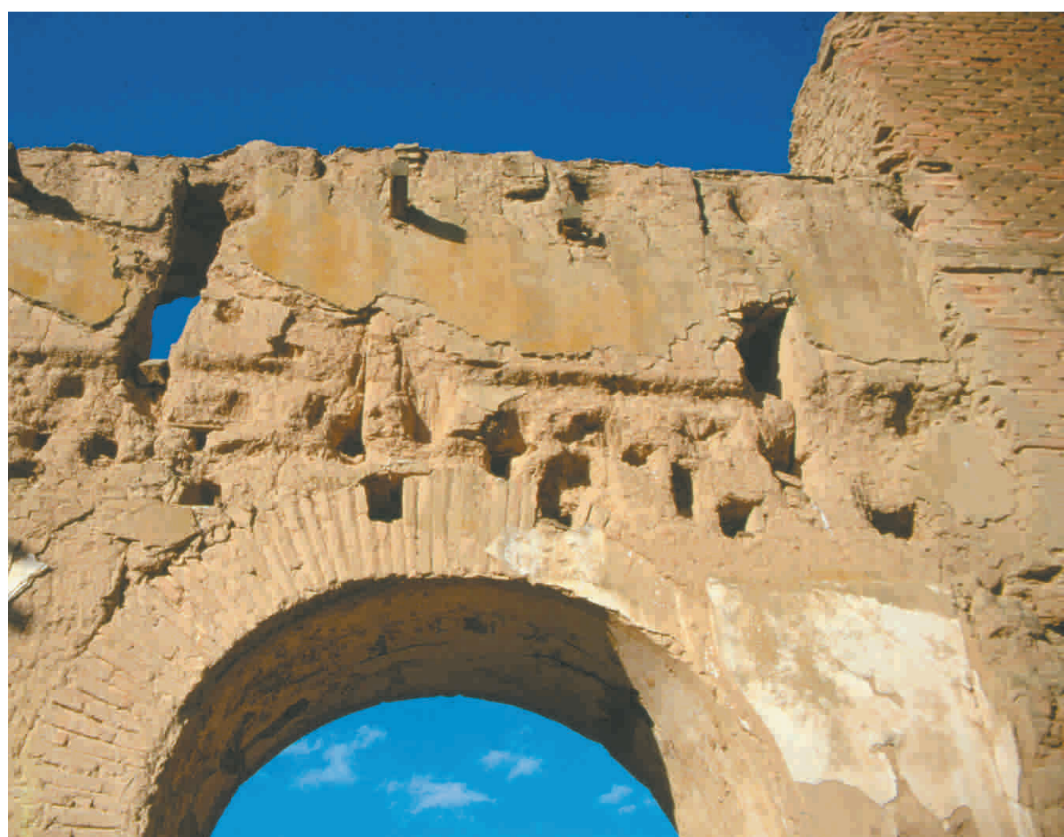
Puerta en la nave del Evangelio. La caída de los revestimientos permite ver los gruesos muros de tapia sobre el arco de ladrillo.
