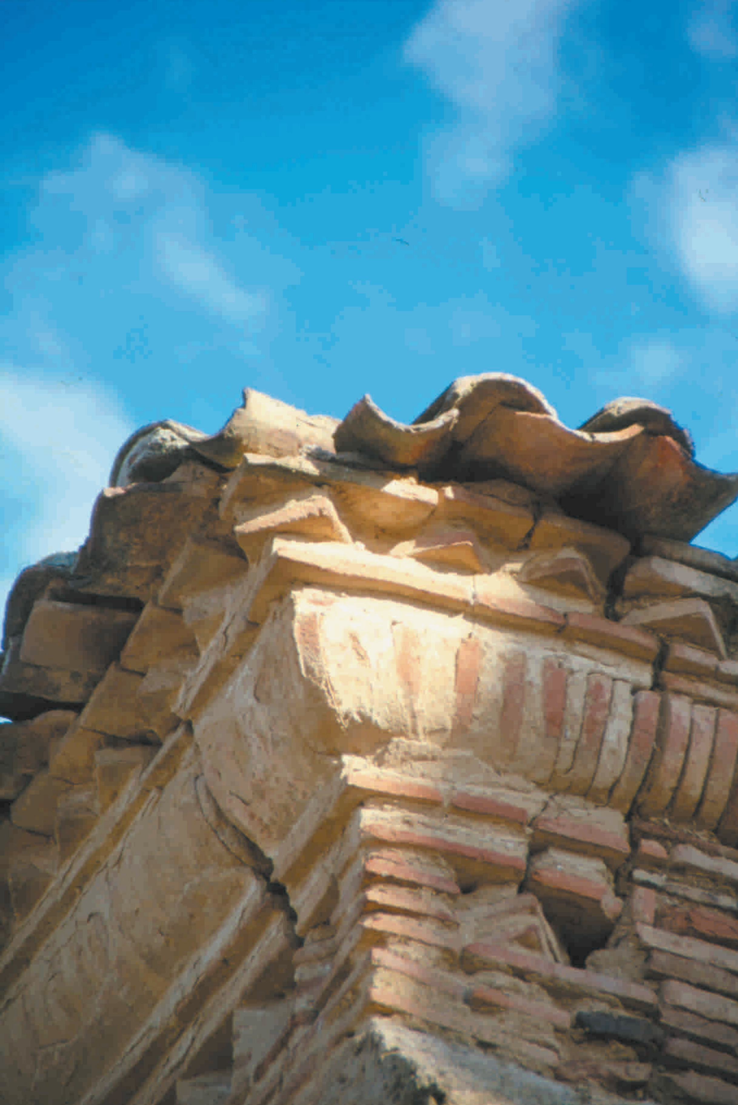
Típico alero de remate en Tierra de Campos realizado a base de ladrillos aplantillados o en esquina.
