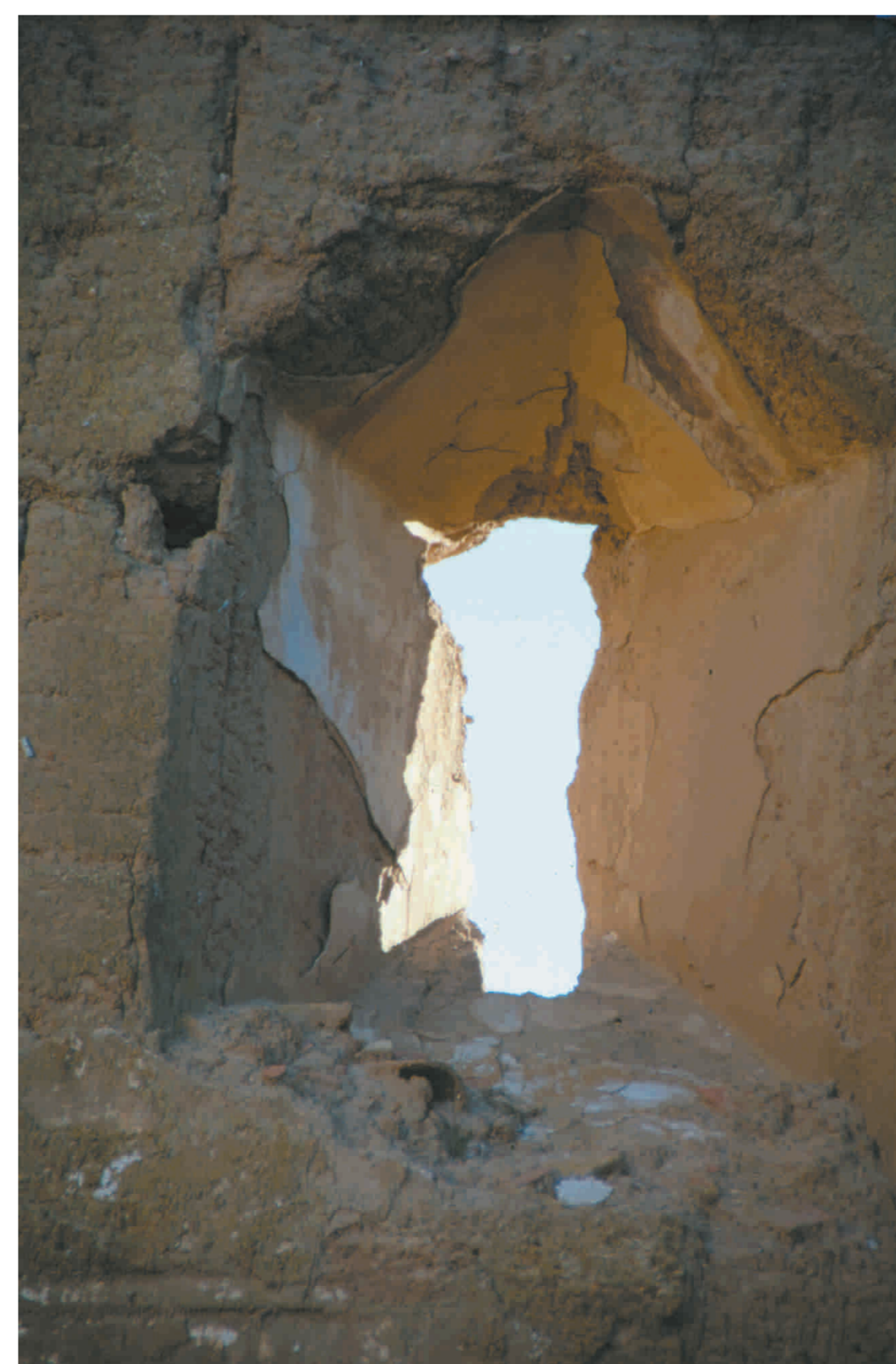
Ventana abierta en la tapia de tierra en la que todavía se ve una cabeza pintada que luego fue cubierta con un revoco posterior.
