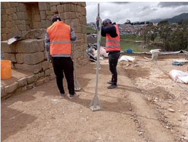
Trabajos de compactación en la plataforma de la Elipse. (Foto: M. Pesantes, 2022)
