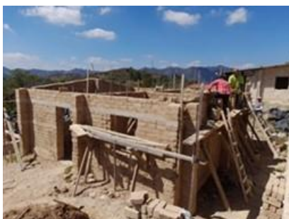
En la construcción se han considerado las esquinas con cruces antisísmicos
