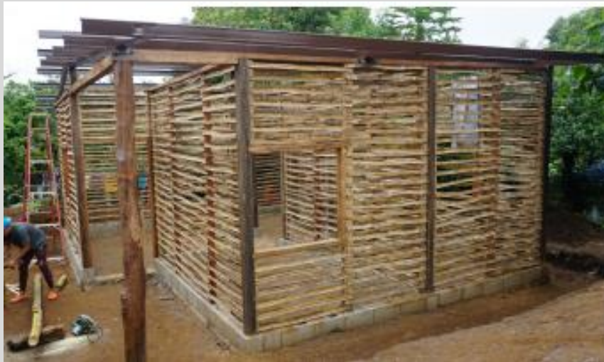
Proceso constructivo de vivienda de Bersaides con el sistema de bahareque mejorado envarillado con vara de bambú
