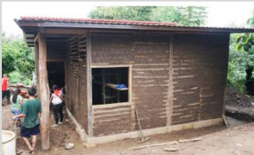
Proceso constructivo de vivienda de Bersaides con el sistema de bahareque mejorado y su embarre
